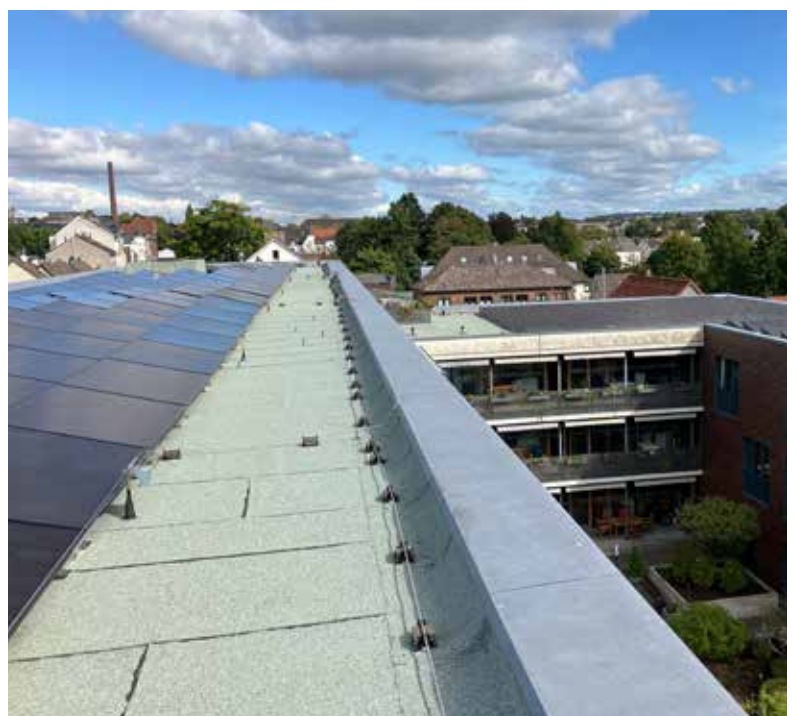
▲ Neue Photovoltaikanlagen auf den Dächern des „SeniorenWohnens“ im Weegerhof
