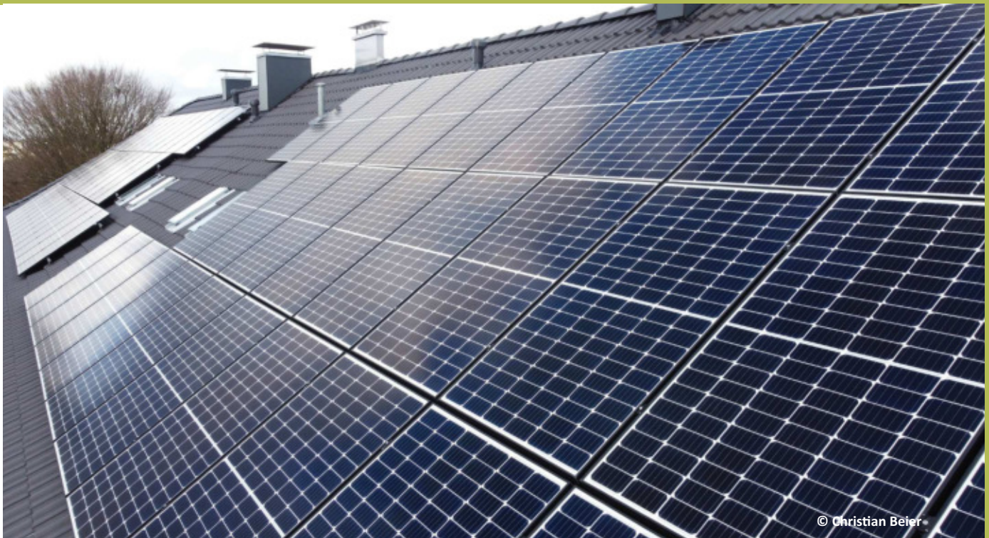
▲ Photovoltaik-Anlage an der Hacketäuerstraße
